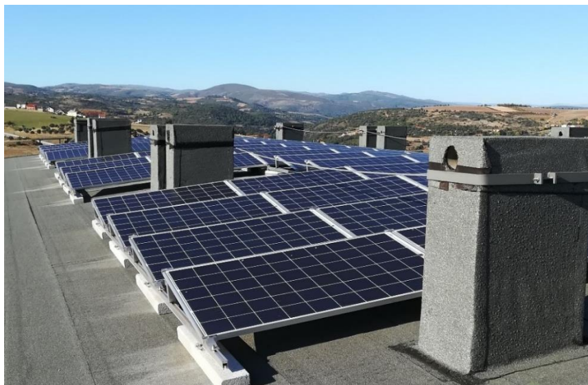
Figura 21: Sistema Fotovoltaico Instalado no Terraço
