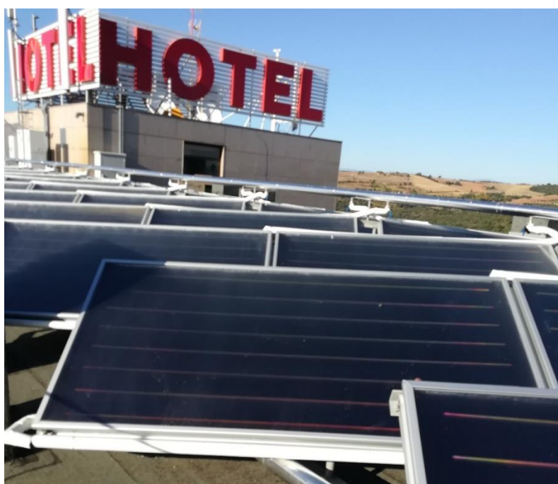
Figura 25: Sistema Solar Térmico Instalado no Terraço
