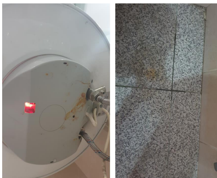
Figura 21. À esquerda, cilindro com marcas de ferrugem. À direita chão molhado e enferrujado devido a perdas de água pelo cilindro
