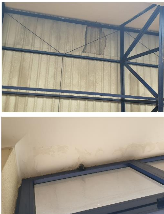
Figura 38. Em cima, degradação da cobertura de fibrocimento, em baixo marcas de humidade presente na laje
