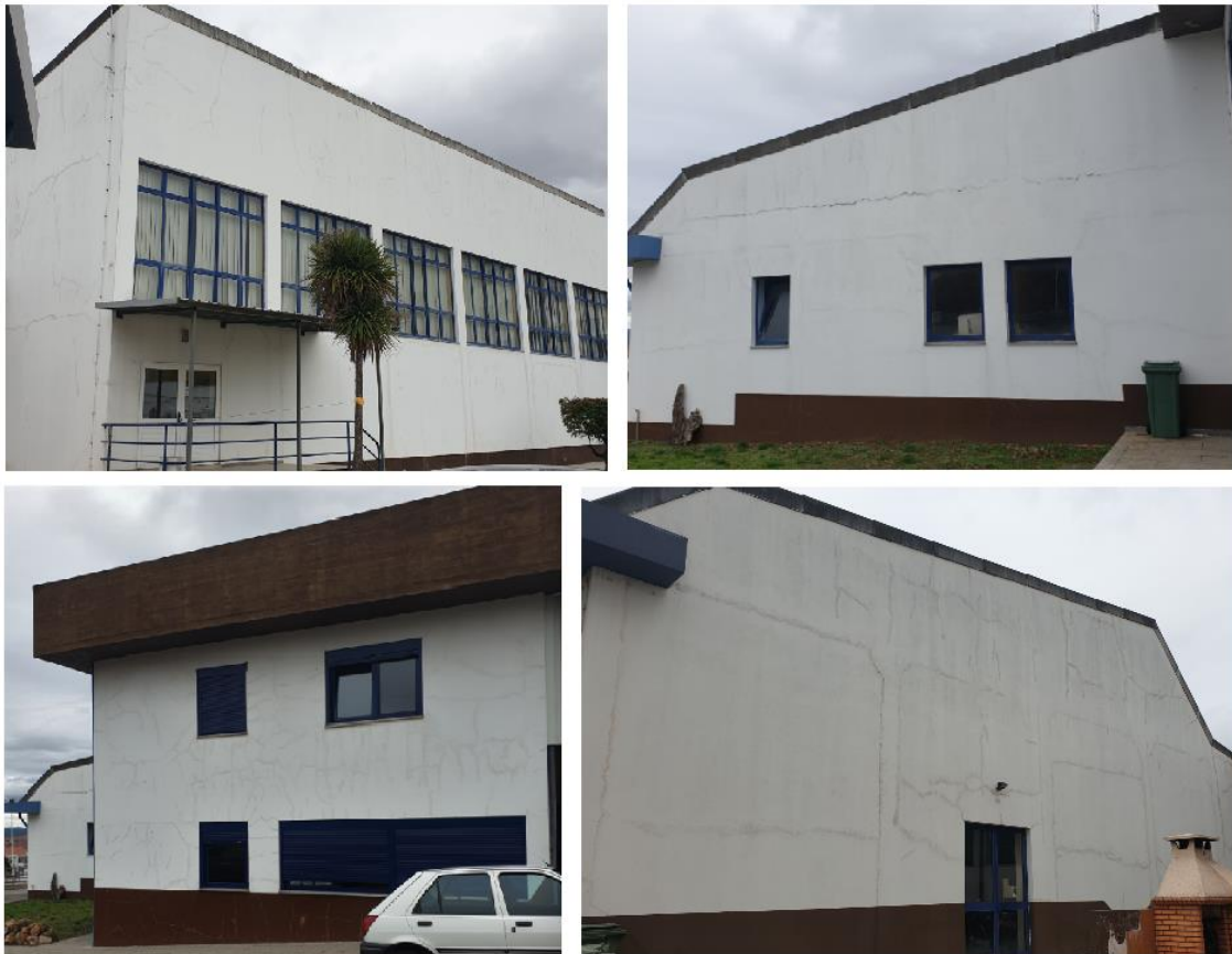
Figura 37. Imagens da degradação das paredes exteriores
