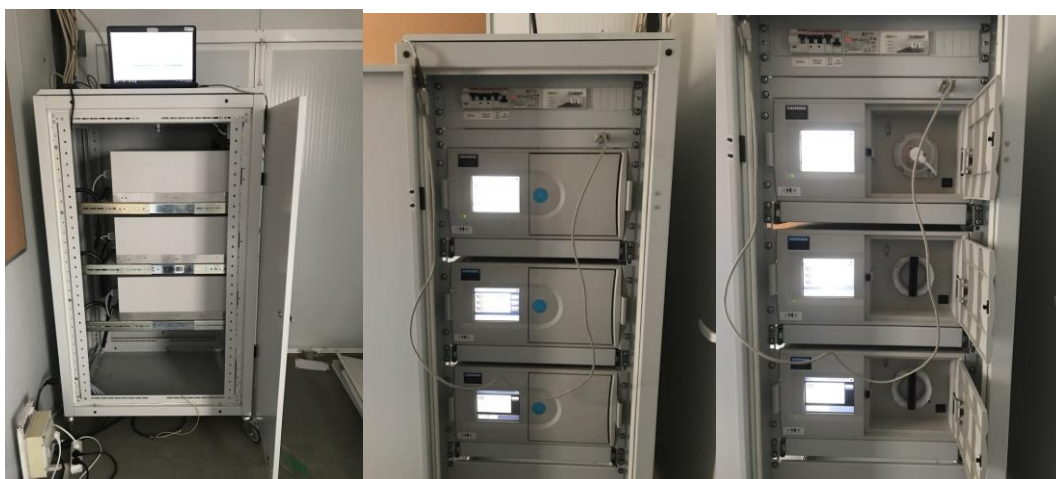
Figura 34 - Instalação dos monitores de poluentes atmosféricos na ZIM.
