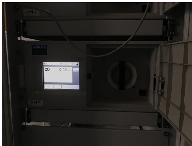
Figura 36 - Analisador Horiba APMA-370 de monóxido de carbono (CO).
