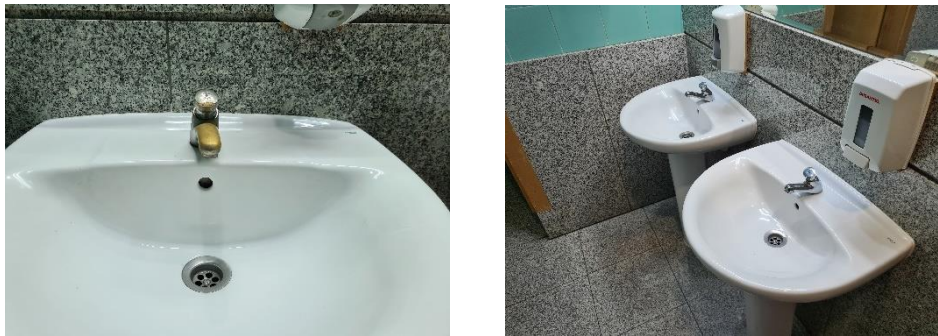
Figura 18 - Torneiras das instalações sanitárias
