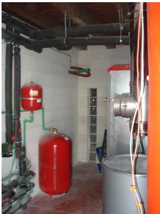
Fig. 8 – Sala da caldeira de biomassa (caldeira alta à direita, com tampa vermelha).
