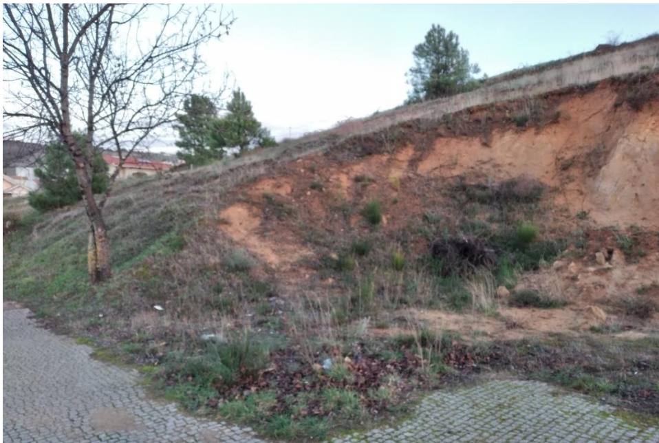
Figura 2: Erosão do solo devido a ausência de vegetação e pela ação antrópica (autoria própria, 2021)
