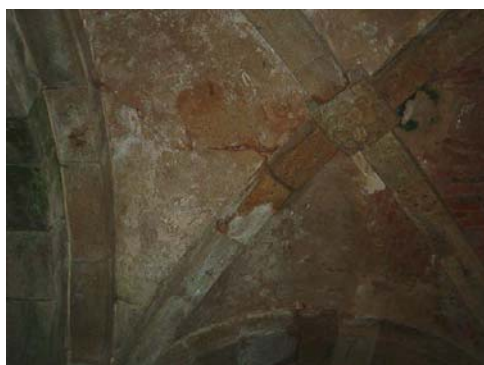
Figura 4.53: Abóbada de tijolo degradado
