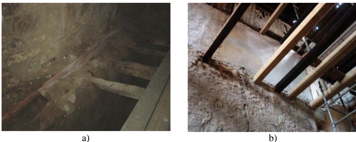
Figura 5.10: a) Entrega de antigos barrotes ao nível do piso rés do chão b) Entregas de novos barrotes ao nível do piso 2
