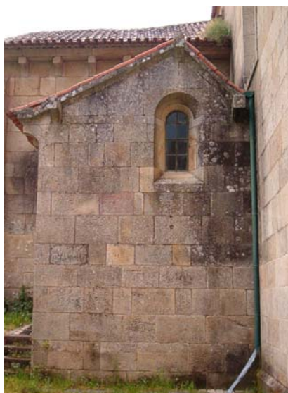
Figura 4.72: Manifestações de fungos e líquenes no exterior
