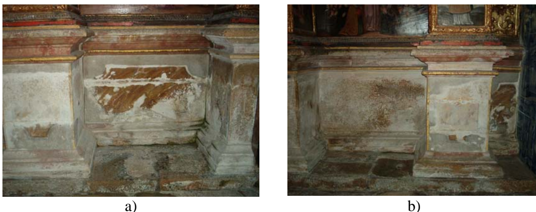
Figura 4.73: Manifestações de humidade nos paramentos e pavimentos (ala lateral direita – Orientação Sul)
