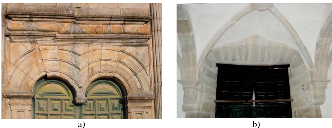
Figura 4.34: a) Detalhe do deslizamento vertical das pedras dos arcos sobre a porta principal da Igreja; b) Pormenor de deformação da padieira vista pelo interior
