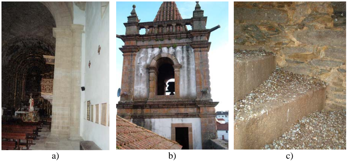
Figura 4.35: a) Desaprumo de um contraforte no interior da Igreja; b) Ocorrência de manifestações de humidades; c) Aspecto da escada da torre com a permanência das aves
