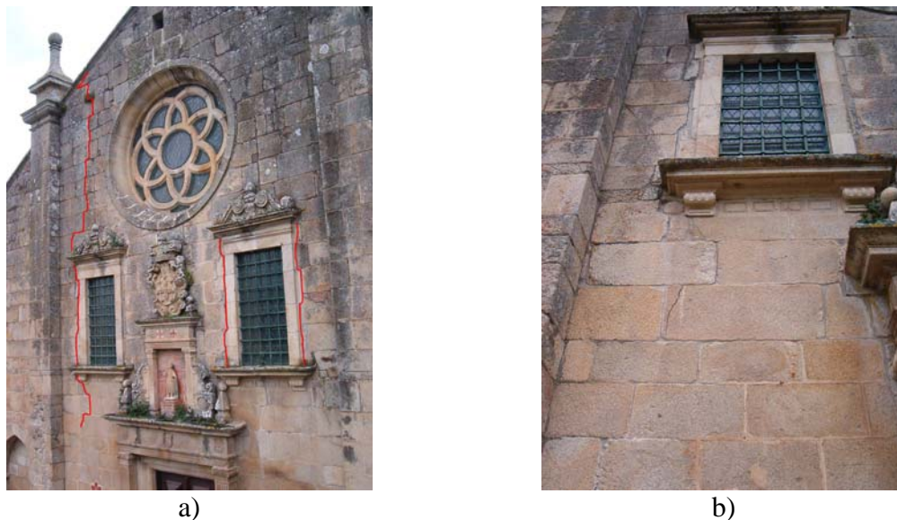
Figura 4.66: Fissuras na fachada principal; a) Esquema de desenvolvimento das fissuras (fechadas com argamassa); b) Pormenor de reabertura das fissuras anteriormente fechadas
