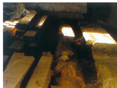
Figura 4.10 [4a]: Degradação da viga de madeira
