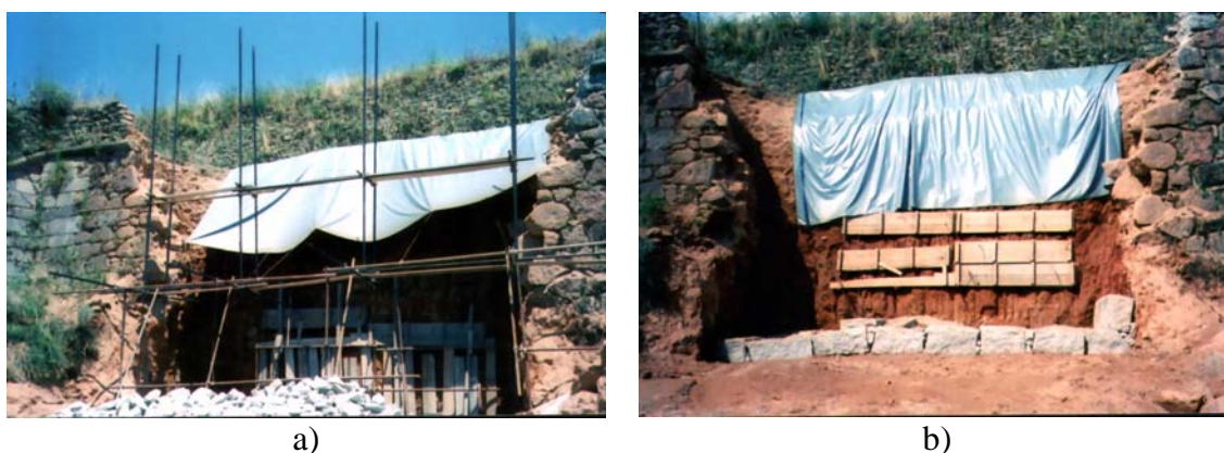
Figura 4.38 [4e]: Entivações, escoramentos e protecção das terras encostadas ao paramento interior da muralha
