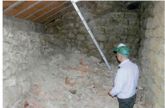
Figura 4.69 [4l]: Entulho sobre as abóbadas das naves laterais da igreja
