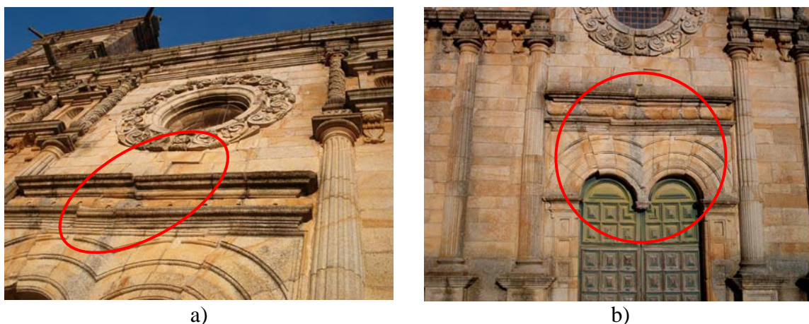
Figura 4.28: a) Deslizamento de blocos de granito para o exterior b) Deslizamento parcial entre alguns blocos de granito da fachada
