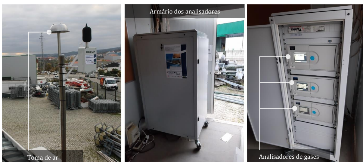
Figura 8 – Sistema de monitorização de gases. (esquerda) toma de ar responsável pelo suporte e proteção das tubagens de aspiração do ar ambiente até aos analisadores; (centro) armário do tipo rack dos analisadores;(direita) disposição dos analisadores de gases no interior do armário
