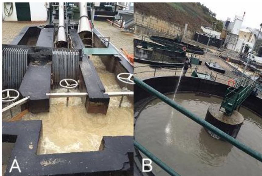
Figura 12 - Detalhes fotográficos da ETAR de Bragança: A. Obra de entrada; B. Decantador Primário.
