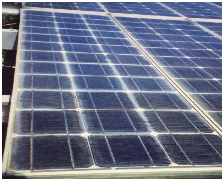
Figura 5.3 - Oxidação da malha metálica das células [28]
