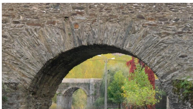
Figura 3.7 - Arco com espessura irregular (ponte nº 70)
