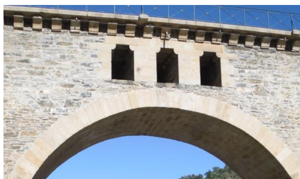
Figura 3.12 - Enchimento aligeirado sobre a chave do arco (ponte nº 51)
