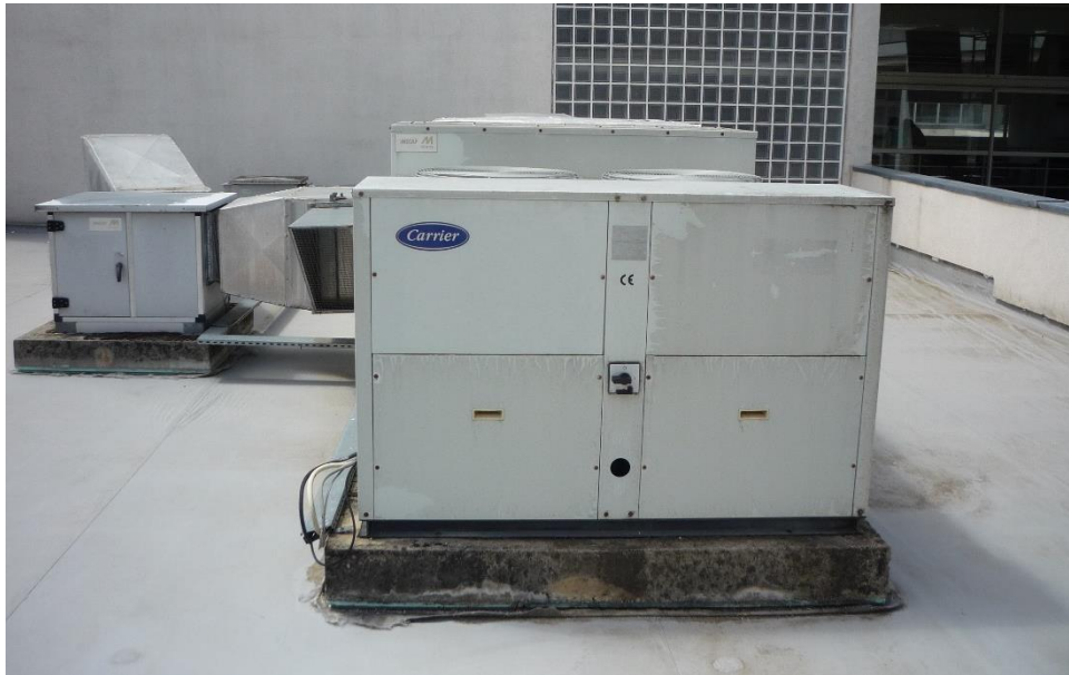
Figura 5.2.5.1-3 Unidade de tratamento de ar do anfiteatro
