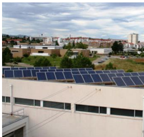
Figura 5.3.1.2-2 Sistemas fotovoltaicos instalados na cobertura (VERCAMPUS, 2014)
