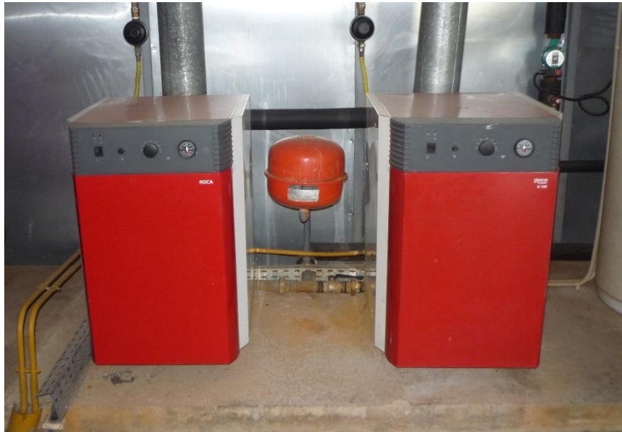
Figura 5.2.5.1-4 Caldeiras para o aquecimento de água quente sanitária
