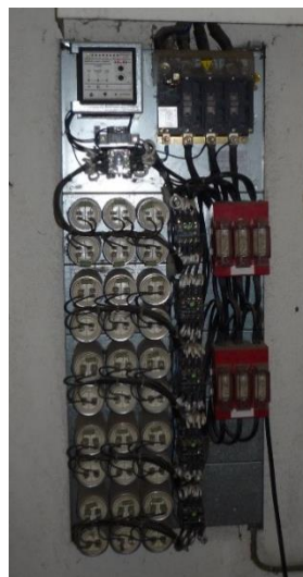
Figura 5.3.1.3-1 Banco de condensadores instalados para corrigir o fator de potência
