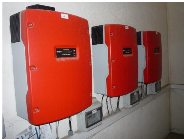
Figura 5.3.1.2-1 Conjunto de inversores SMC 5000A do edifício em estudo
