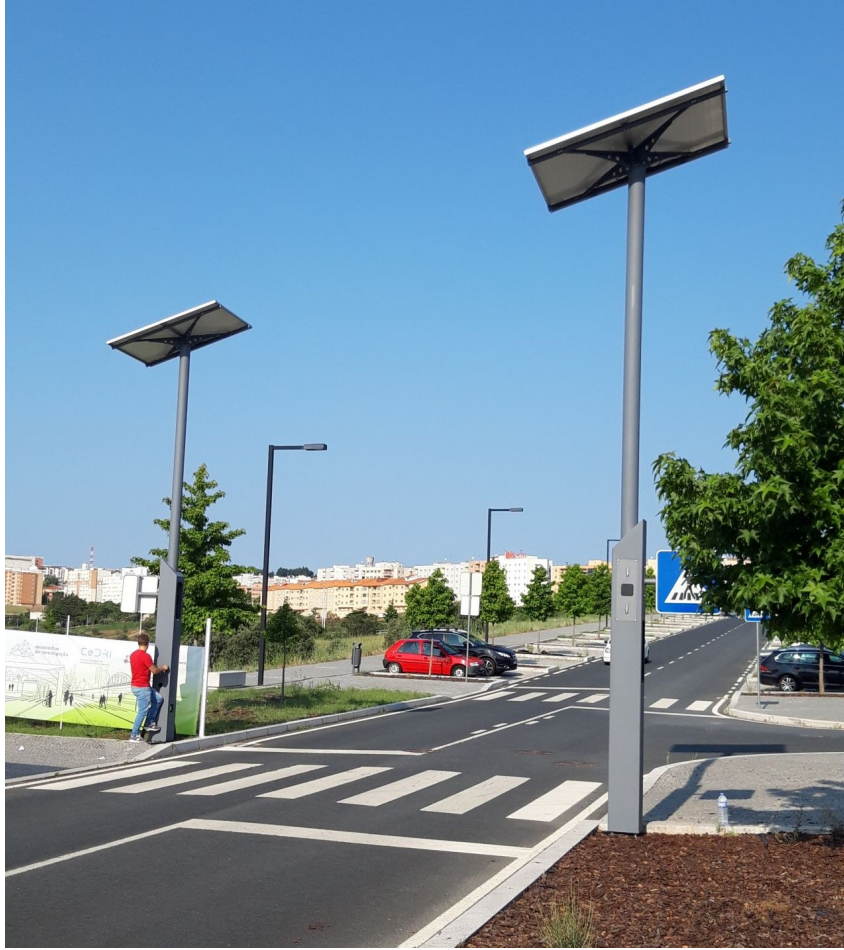
Figure 4.1: VALLPASS units installed in the Avenida Cidade de León, Bragança.
