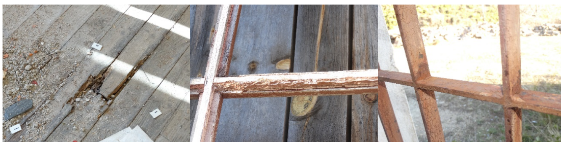
Figura 16 – (a) Aspeto degradado do soalho de madeira, (b) Aspeto da caixilharia de madeira das janelas, (c) Aspeto da oxidação do portão de entrada
