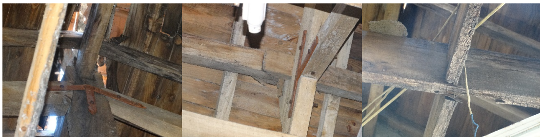
Figura 14 – (a) Zona da cobertura em falta junto à cumeeira, (b) Desençaixe de madre numa emenda, (c) Estrutura de apoio ao forro deteriorada.
