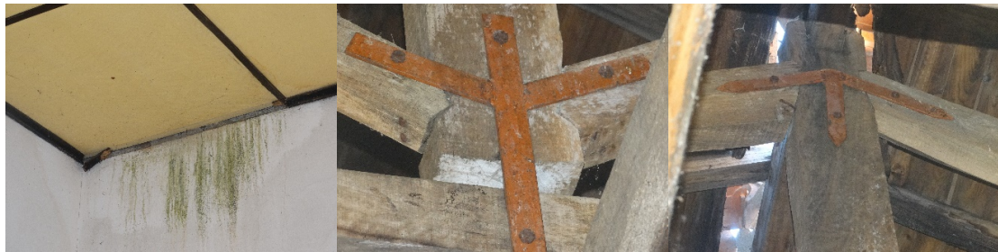
Figura 13 – (a) Zona de parede com colonização biológica, (b) Folgas visíveis nas samblagens, (c) Folgas visíveis nas samblagens
