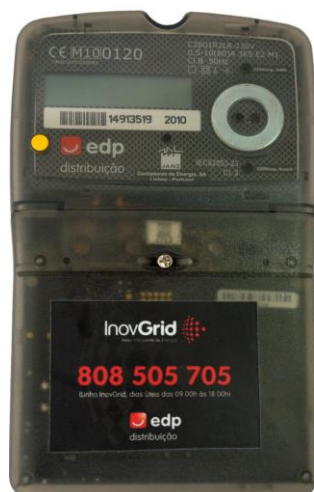
Figura 3 - Smart Meter do projeto InovGrid(EDP). [4]
