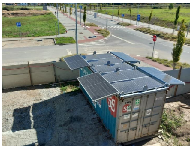
Figura 2: Painéis Fotovoltaicos Instalados em Obra (Empreendimento Mereces/Barcelos).
