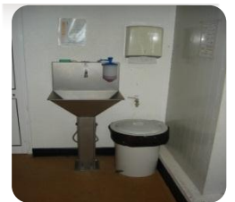
Fig.7- Lavatório com Torneira com Pedal
