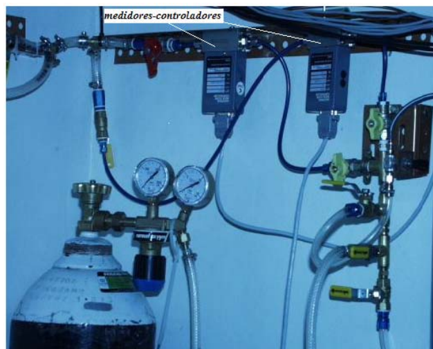
Figura 3.5- Visualização dos medidores-controladores do caudal de gás.
