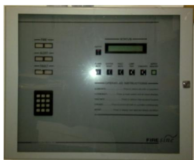
Figura 6.7 - Central de incêndios existente no edifício
