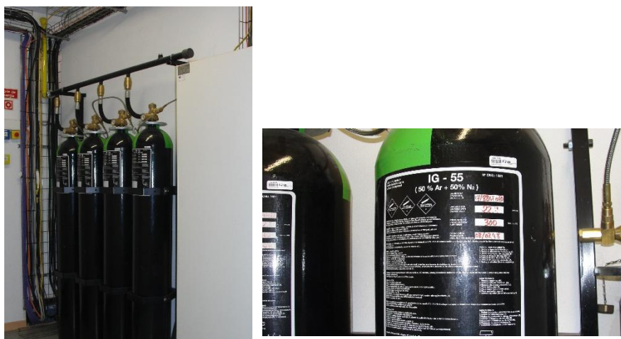
Figura 6.10- Sistema de Gás INERGEN/IG55 instalado
