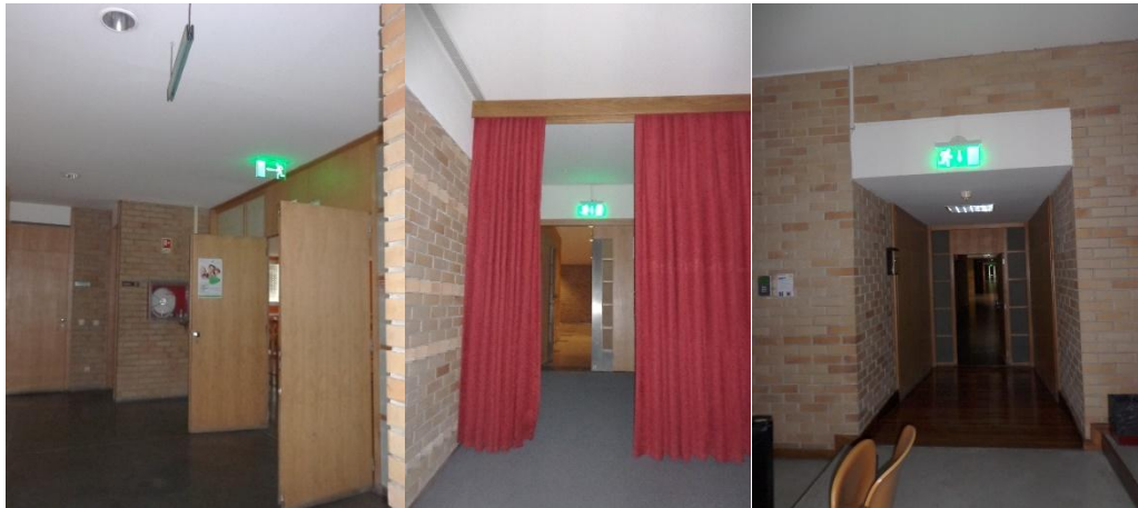
Figura 6.9- Iluminação de emergência nas saídas de locais de risco B
