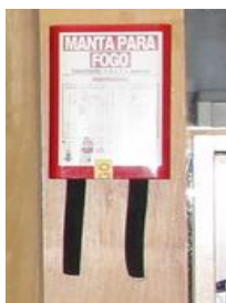
Figura 6.4 - Manta ignífuga existente no Laboratório de Química Analítica
