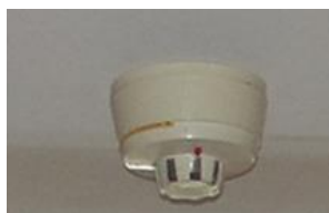
Figura 6.6 - Detetor ótico de fumo existentes
