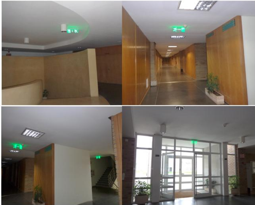
Figura 6.8- Iluminação de emergência, nas vias horizontais de evacuação
