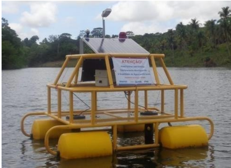
Figura 1.1: Unidade de monitoramento remoto [5]
