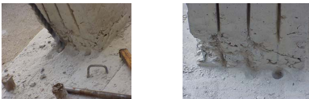
Figura 3.20 – Desmonte da zona de selagem e abertura dos orifícios de ancoragem dos laminados.
