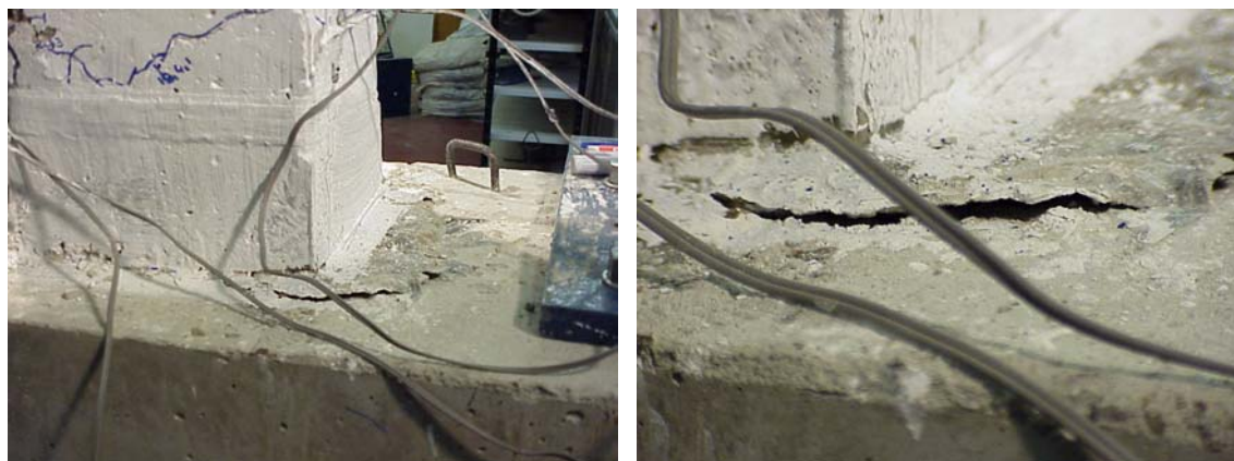
(a) (b) Figura 5.51 – Deficiência no reforço do pilar P16bCR.
