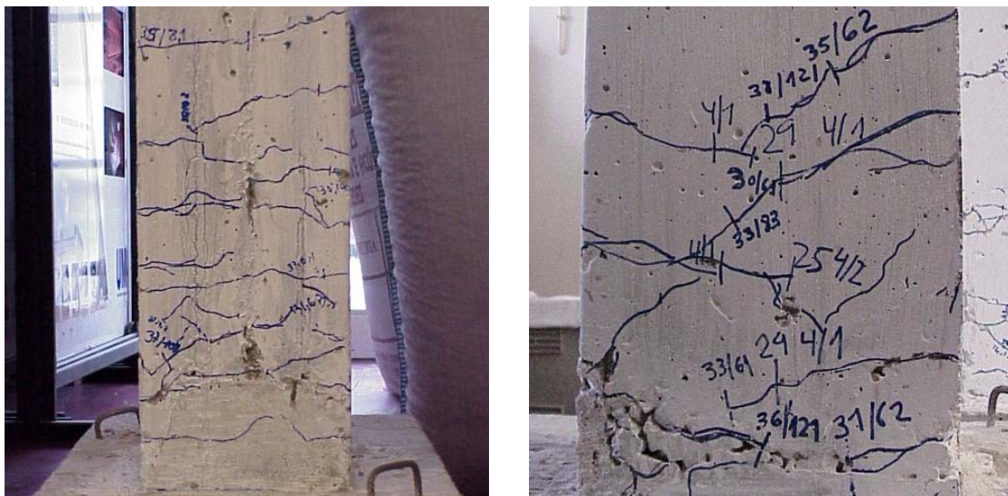
(a) (b) Figura 5.46 – Aspecto exterior do P10aPR: (a) vista geral; (b) pormenor da zona de fendilhação do pilar.
