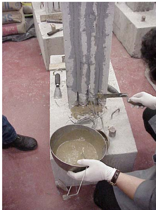
Figura 3.35 – Aplicação da argamassa epóxida na zona da rótula plástica e nos orifícios da sapata.
