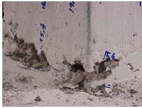
Figuras 3.18 – Fragmentação do betão de recobrimento na zona da rótula plástica.
