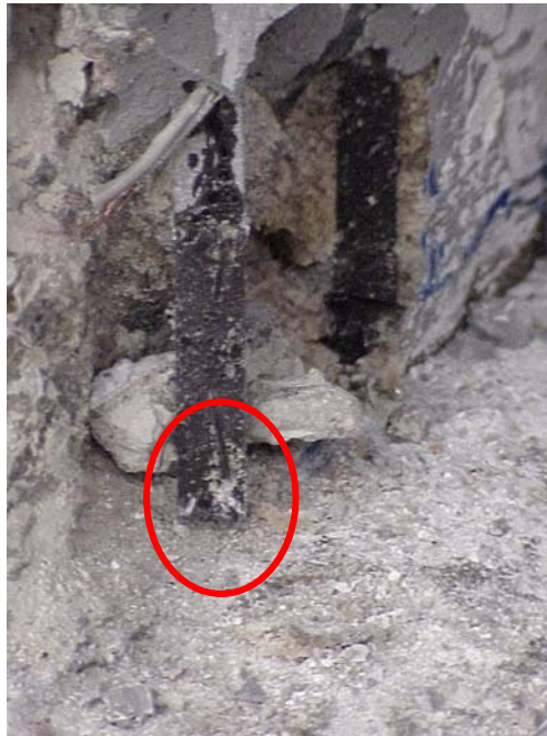
Figura 5.22 – Rotura do laminado após ter sido ensaiado.
