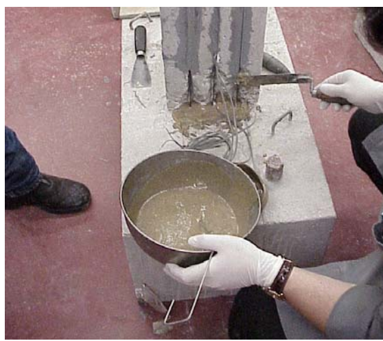
Figura 2.17 – Aplicação da argamassa epóxida nos buracos de fixação dos laminados à sapata.
