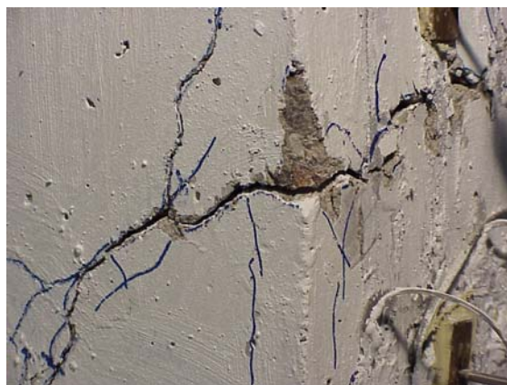
Figura 5.49 – Rotura do P16aCR pela fenda existente que não foi selada.
