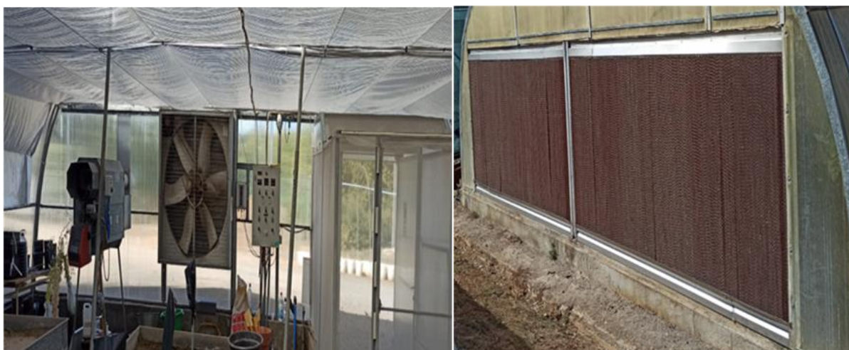
Figura 2. Vistas internas do ventilador (esquerda) e do painel húmido (direita) do sistema de arrefecimento.
