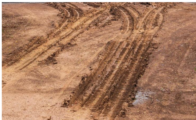
Figura 13 - Afundamentos em estradas não pavimentadas Fonte: VECTEEZY (2024).
