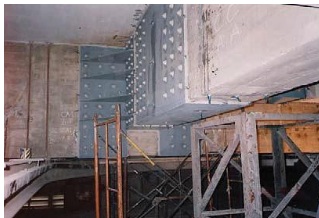
Figura 2.6 – Reforço com chapas de aço
