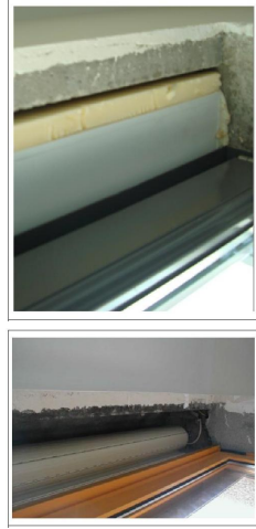
Fig. 6. Soluções de caixas de estores em edifícios construído antes e após a entrada em vigor do RCCTE-2006
