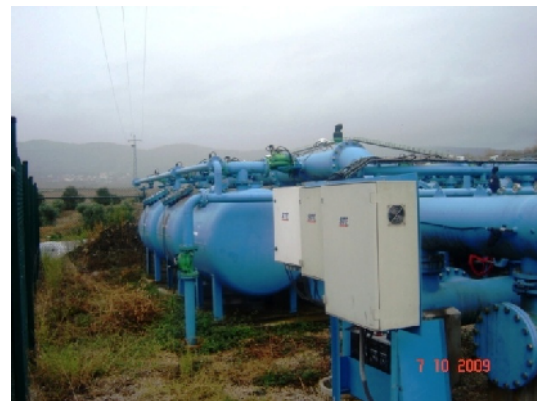
Figura 19 - Quadro de comandos do sistema de filtração
