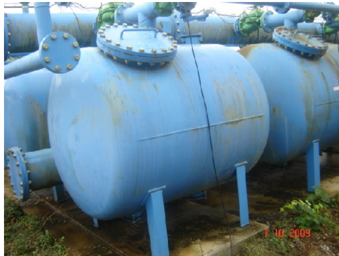
Figura 18 - Filtros de areia
