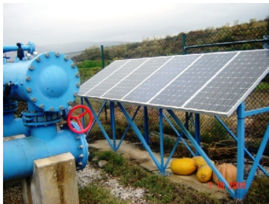
Figura 20 - Pannel solar que alimenta o quadro de comandos
