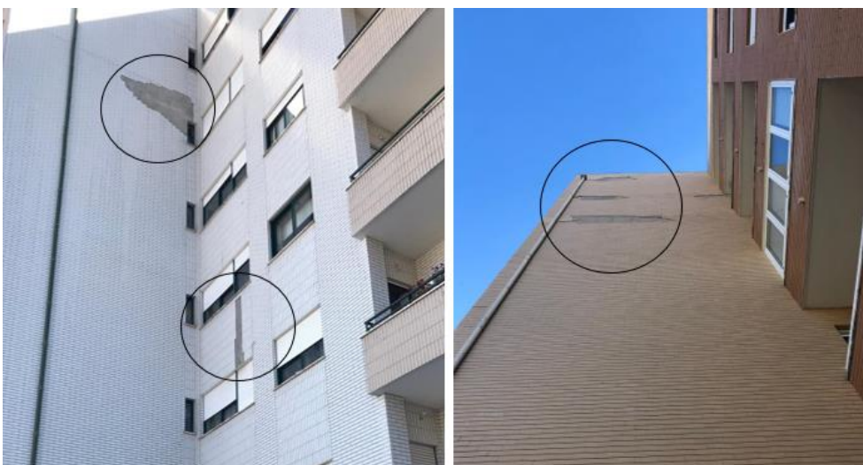
Figura 7.40 - Descolamento do revestimento cerâmico nos edifícios O (Esquerda) e P (Direita).
