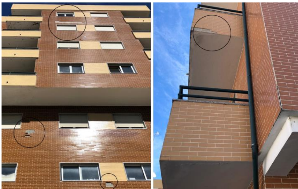
Figura 7.39 - Descolamento do revestimento cerâmico nos edifícios F (Esquerda) e M (Direita).
