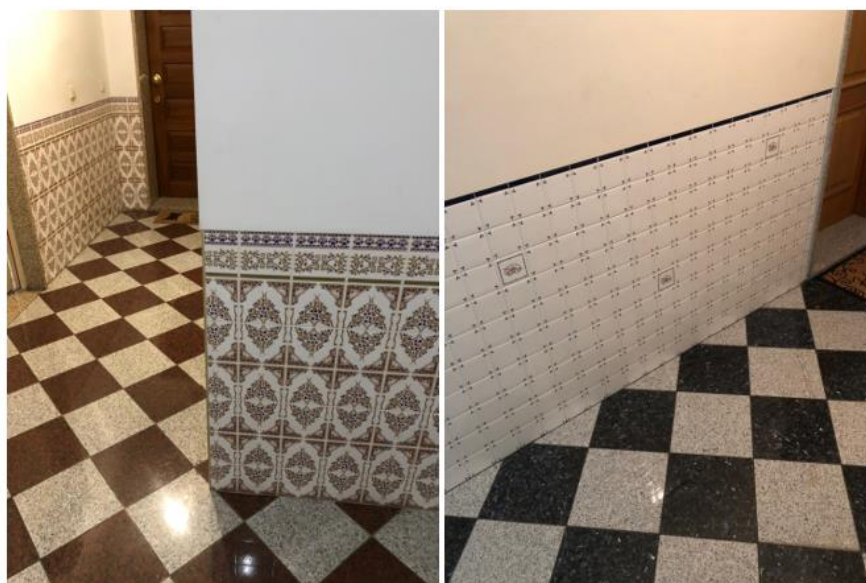
Figura 7.45 - Revestimento de paredes de áreas comuns dos edifícios F (Esquerda) e M (Direita).
