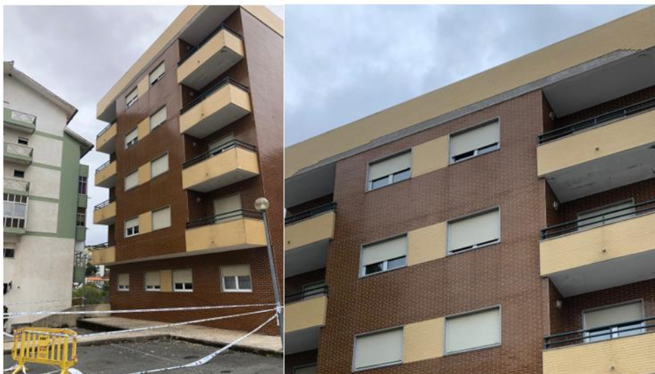
Figura 7.41 - Descolamento do revestimento cerâmico do edifício "F" no dia 15 de outubro de 2019.
