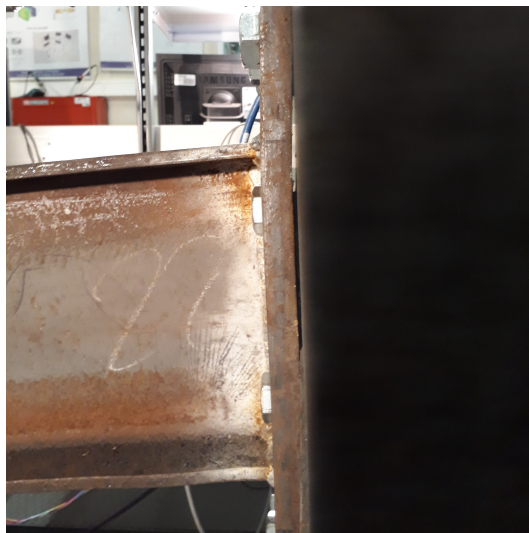
Figura 4.15: Deformação plástica na placa de fixação da viga B1.
