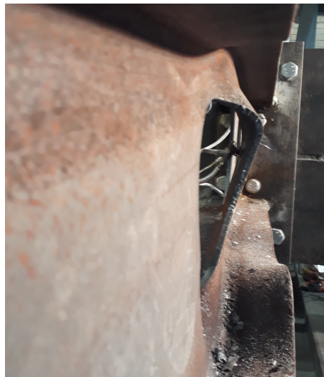
Figura 4.20: Deformação plástica no montante da alma na Viga B5.
