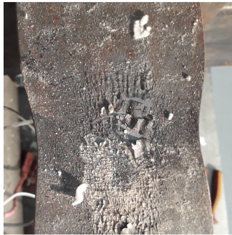
Figura 4.23: Deformação plástica no banzo superior da Viga B7, entre secção 1 e 2.
