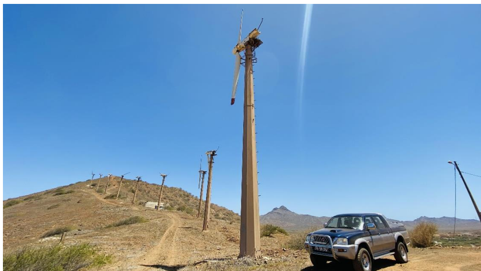
Figura 22- Parque Eólico da Ribeira de Vinha (Vista Lateral)
