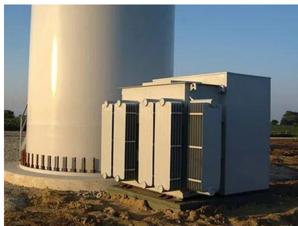
Figura 17-Transformador Trifásico de um Aeroogerador [29]
