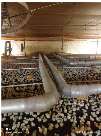
FIGURA 4.51 - Aquecimento a lenha localizado no exterior do aviário. O calor é distribuído para o interior através de tubos por meio de um motor.
