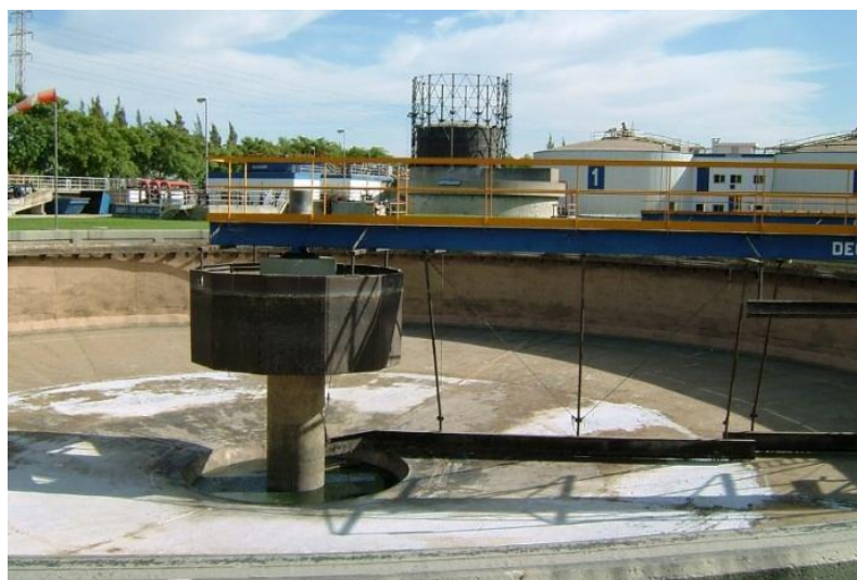
Figura 5 – Decantador primário (APA, 2017).
