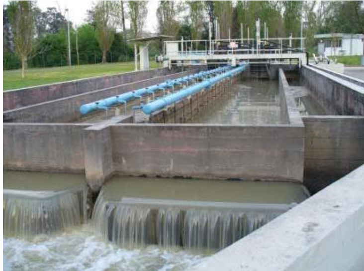
Figura 4 – Tanque Desarenador/Desengordurador (APA, 2017).
