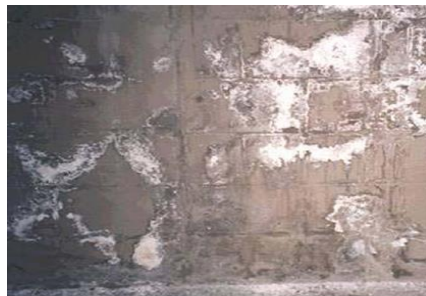
Figura 1 - Deposição à superfície de sais dissolvidos pela percolação de água no interior do betão (6).
