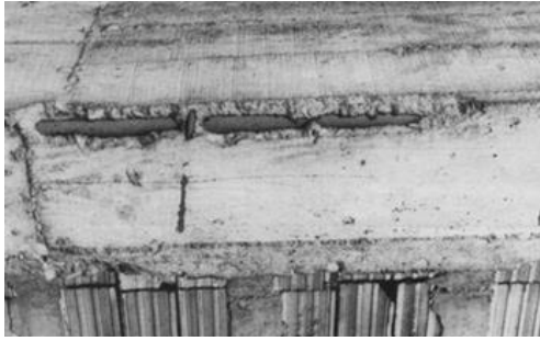
Figura 2 - Descasque do bordo de uma laje provocado pela corrosão das armaduras (7).
