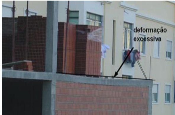
Figura 9 - Deformação excessiva de laje fungiforme (9).
