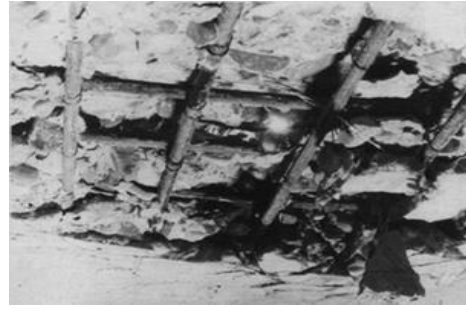
Figura 3 - Descasque em uma laje provocada por carga excessiva (7).
