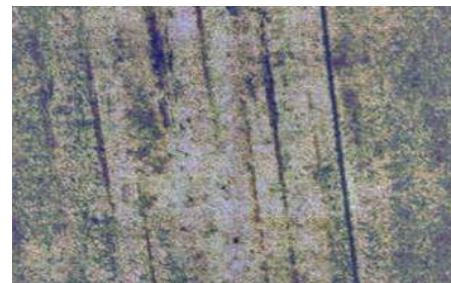
Figura 5 - Manchas de ferrugem(7)
