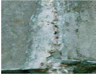
Figura 6 - Junta de betonagem mal executadas (7).
