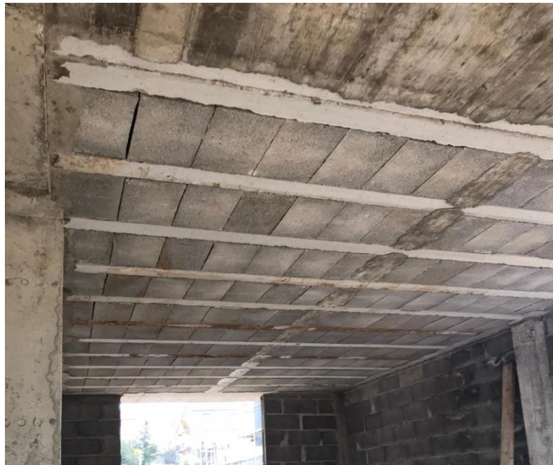
Figura 18 - Foto inferior da laje ensaiada
