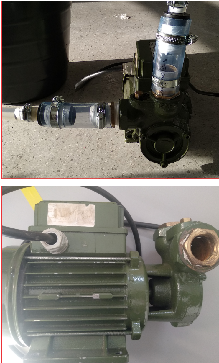
Figura 4.18: Bomba de água.
