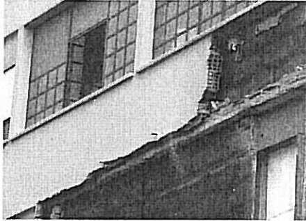
Fig. 1 – Colapso de um pano de parede exterior não confinado
