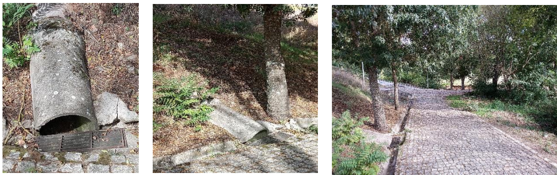
Figura 5- Manilhas de concreto para direcionamento das águas pluviais da Avenida de Sá Carneiro para o rio Fervença.
