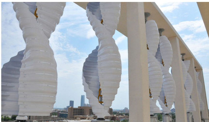
Figura 1.1: Algumas das 18 turbinas eólicas verticais V2 (rotor tipo Savonius) omnidirecionais com cerca de 5,6 m de altura (Venger (2015)).
