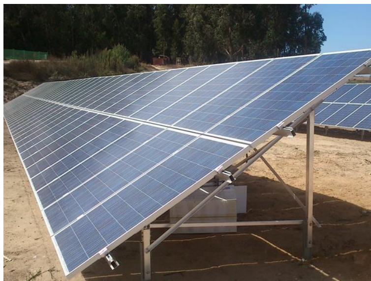
Figura 2.12 - Estrutura fixa para painéis solares fotovoltaicos [20]
