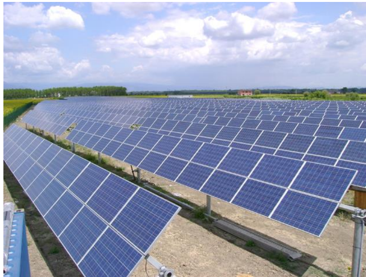
Figura 2.13 - Estrutura seguidor solar de um eixo horizontal para painéis solares fotovoltaicos [20]
