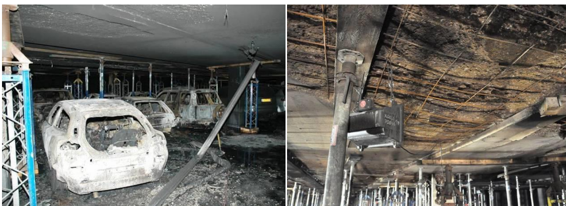
Figura 9 - Incêndio num parque de estacionamento subterrâneo em Haarlem [30].
