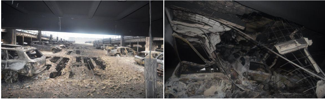
Figura 14 – Danos estruturais ao estacionamento provocados pelo incêndio [35].
