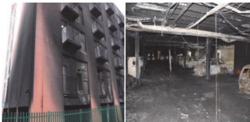
Figura 12 - Incêndio no parque de estacionamento do edifício Monica Wills House [34].
