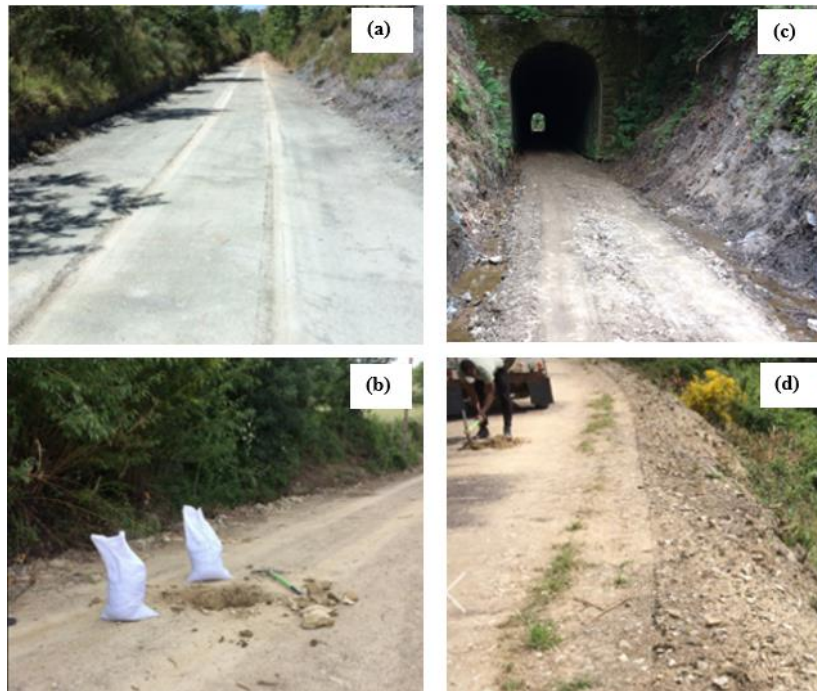
Figura 23- problemas relacionados com drenagem (a)-falta de sistema de drenagem longitudinal na zona em escavação; (c)-deficiencia de drenagem na zona em escavação; (b)-deficiencia de drenagem na zona em aterro e (d)-falta de sistema de drenagem transversal na zona em aterro
