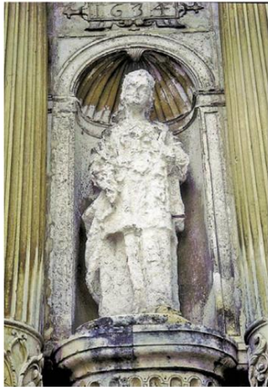
Monumento de calcário danificado pelas chuvas ácidas em Coimbra.
