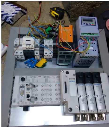
Figura 11 - O variador de frequência instalado no quadro elétrico de aço inoxidável.
