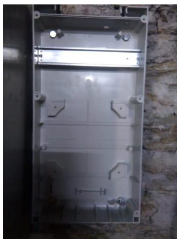
Figura 72 - Localização do quadro elétrico auxiliar.
