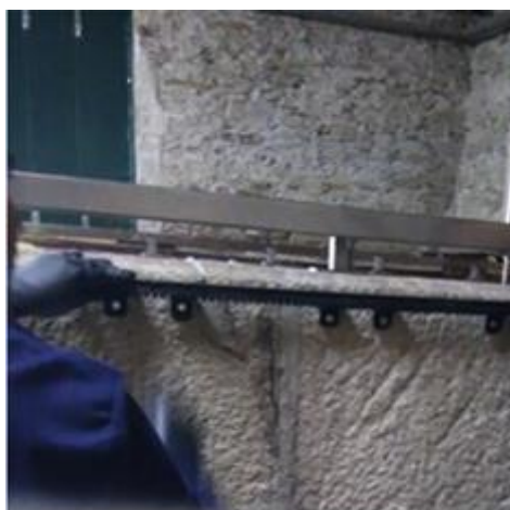
Figura 29 - A fixação da cremalheira à parede lateral do lagar.
