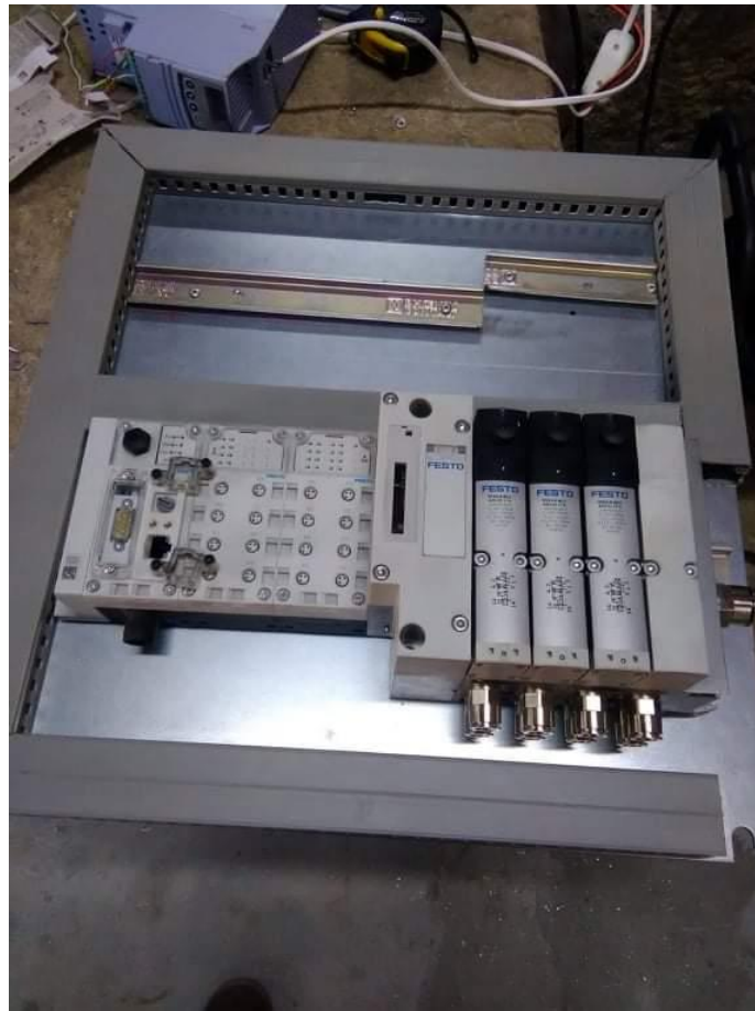
Figura 90 - Posicionamento das válvulas no automático.
