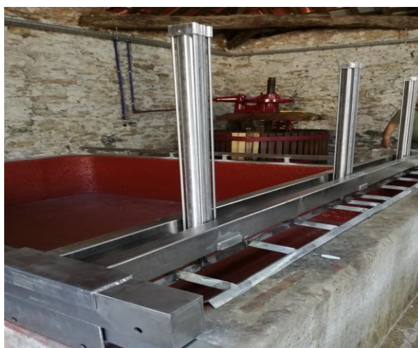
Figura 19 a) - A estrutura de aço inoxidável colocada no lagar.
