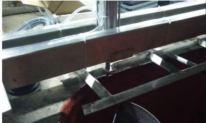
Figura 19 b) - A estrutura de aço inoxidável colocada no lagar.
