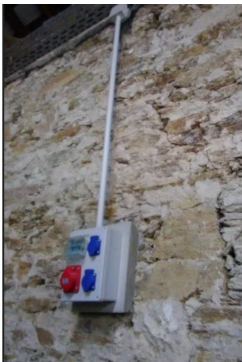
Figura 65 – Estado de conservação da parede para fixação dos quadros elétricos.
