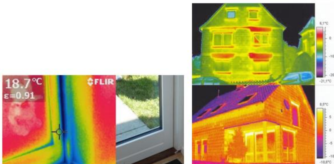
Figura 34 - Termográfica de pontes térmicas num edifício (Abreu 2020)
