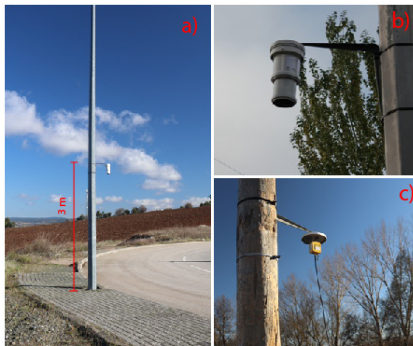
Figura 2.4: Sensores de Temperatura e Humidade relativa: a) Altura de instalação b) proteção de PVC c) Sensor.
